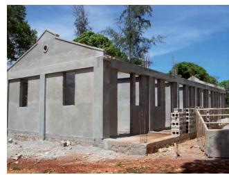
(Avancement de la construction du Lycée des Abricots, Fonds de Solidarité Haïti)
